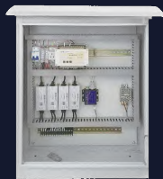
隧道调光控制柜
